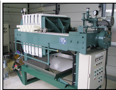
脱水機 (フィルタープレス)
