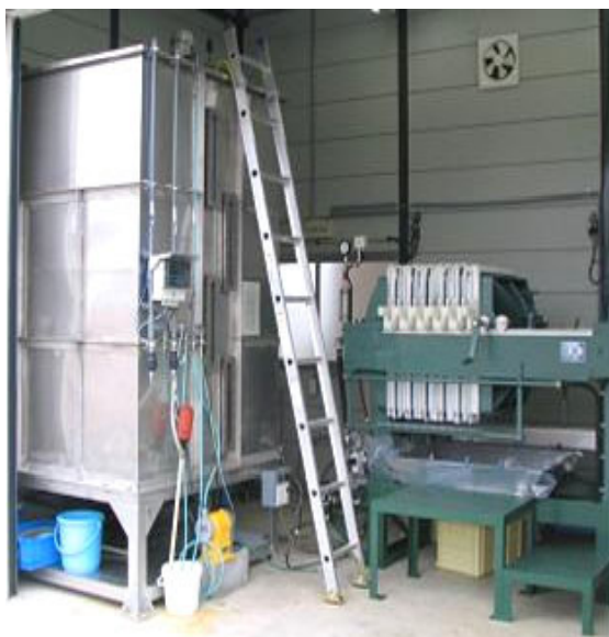
反応槽[4m³]と脱水装置[フィルタープレス]
