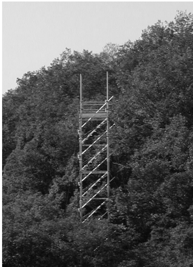
写真 1. 微気象観測タワー 2 号基
