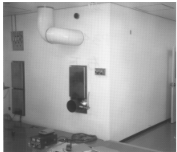
磁気シールドルーム背面部
